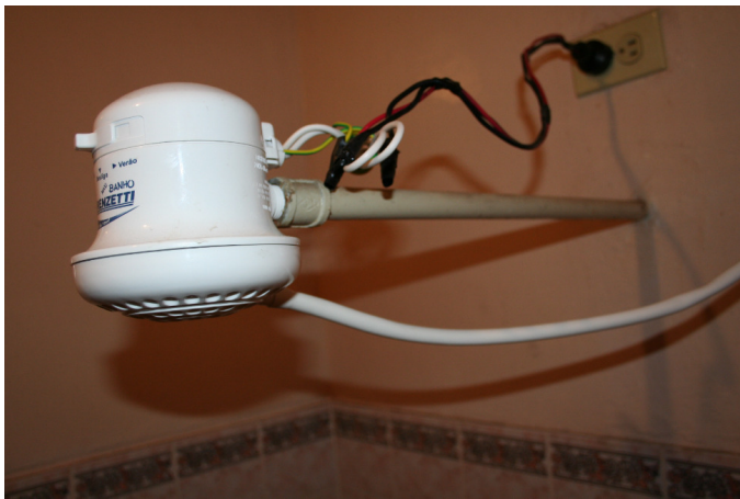
Meine Durchlauferhitzerdusche ... an die Elektroinstallation in der Dusche musste ich mich allerdings zuerst gewöhnen ...
